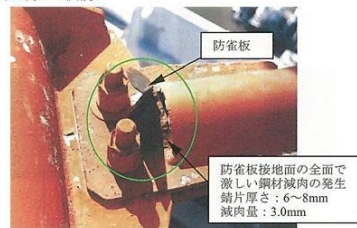
第3-2-4図 異種金属腐食事例（鋼材-ステンレス（防雀板） 6)
